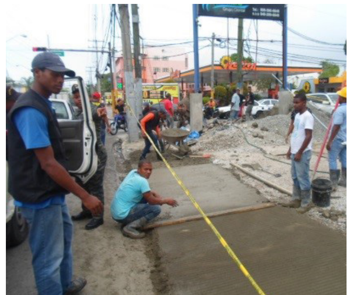
Operativo (Construcción sin autorización)
